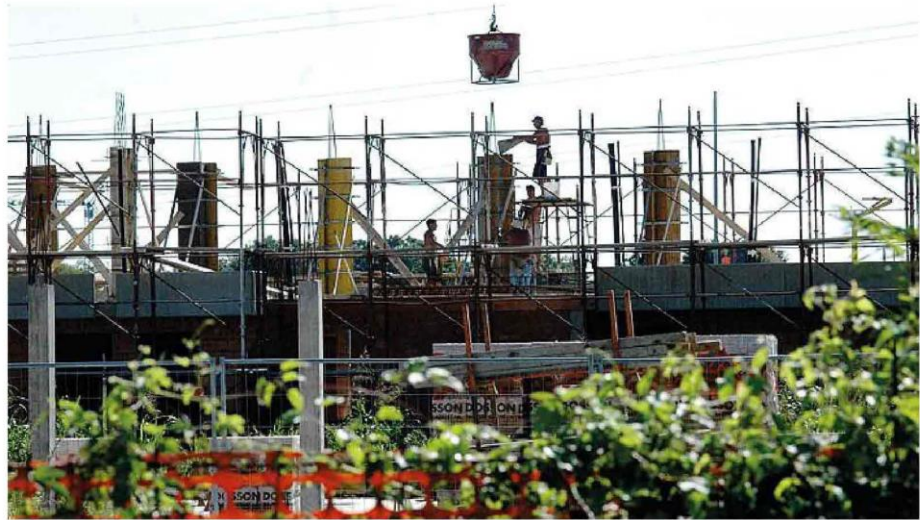
Operai al lavoro in un cantiere edile, la sicurezza deve essere garantita per evitare tragedie
