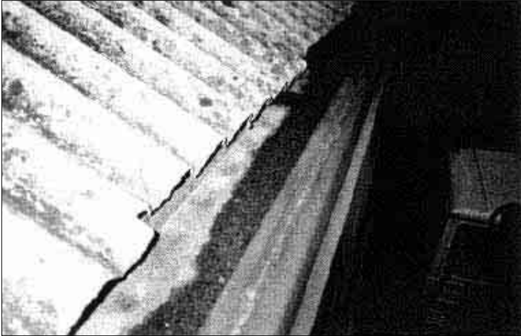
21. Tetto in lastre ondulate di cemento-amianto in situazione di degrado; si osserva, nel canale di gronda, la presenza di detriti derivanti anche da disgregazione e dilavamento del tetto ad opera degli agenti meteorici
