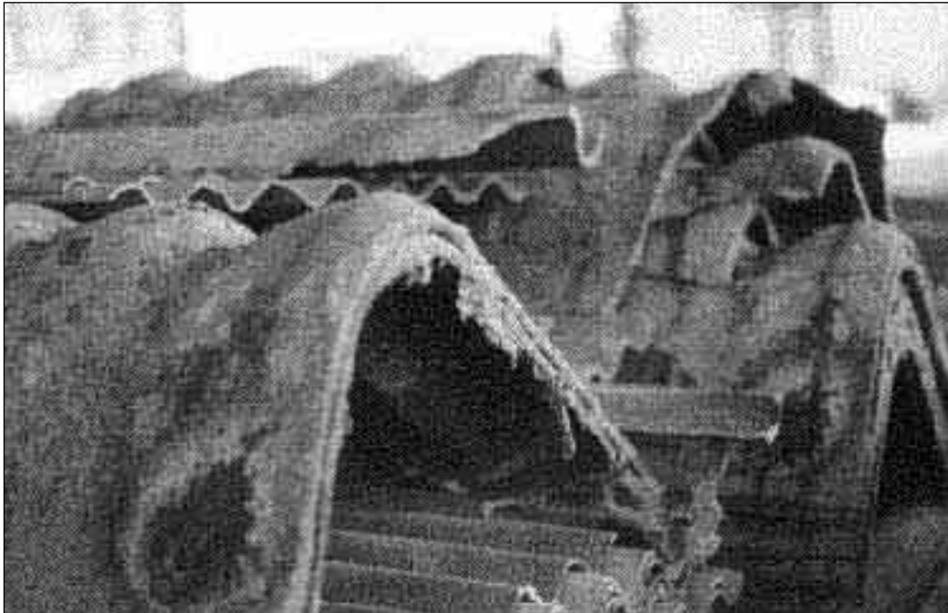
19. Lastre ondulate di copertura in cemento-amianto; si nota la situazione di degrado con fibre che sporgono dalla superficie dei manufatti, a causa del progressivo disgregarsi della matrice cementizia
