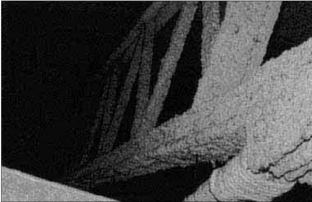
17. Struttura metallica ricoperta con uno strato di amosite applicata a spruzzo, con funzione ritardante del fuoco (in caso di incendio ritarda l'azione della fiamma sulla struttura, impedendo un rapido collasso)
