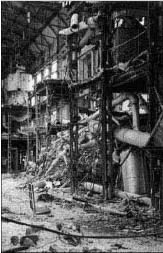
27. (a fianco) Risultato di una demolizione impropria in stabilimento industriale; si osserva un cumulo di tubazioni varie, coibentate con amianto e altri materiali
