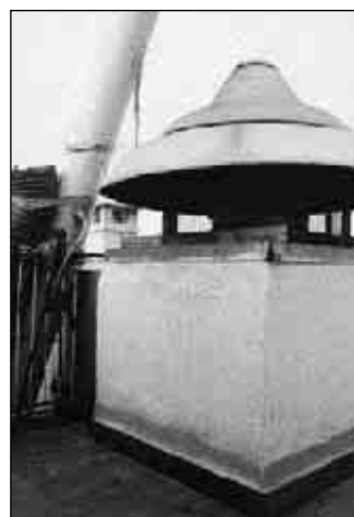
46. Sonda inserita all'interno del camino per il prelievo dell'aria.
