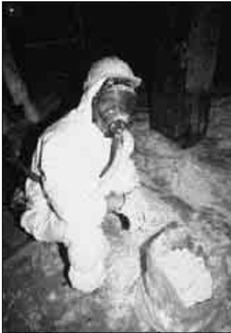
35. Raccolta scorretta del materiale rimosso durante la bonifica.
