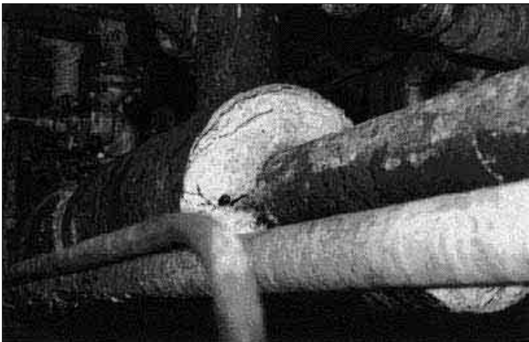
24. Vista di una coibentazione di una tubazione. Si osserva: a) strato bianco spesso a contatto del tubo (coppella in calcio silicato e amosite); b) stratello sottile esterno di colore grigio, costituito da cemento con crisotilo
