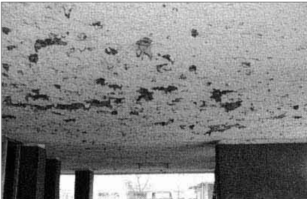
16. Amosite applicata a spruzzo su soffitto di piano piloty di un edificio per abitazione civile: evidente la situazione di degrado del manufatto
