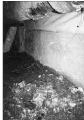
20. Tubazione con contaminazione del terreno.
