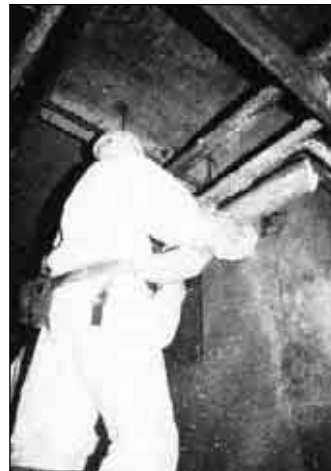
16. Bonifica di una tubazione con distacco manuale di materiale non completamente umidificato.
